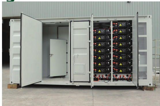
Væskekjølte LFP-batterimoduler i containeren
